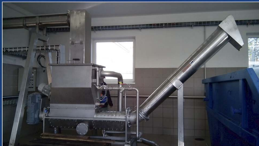
Inštalácia závitkového lisu s praním zhrabkov dopravených dopravníkom TE-ZD
